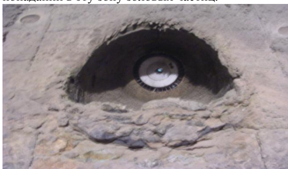
РИСУНОК 4. Шлакование горелок, расположенных в районе кипящего слоя на МСЗ №4
