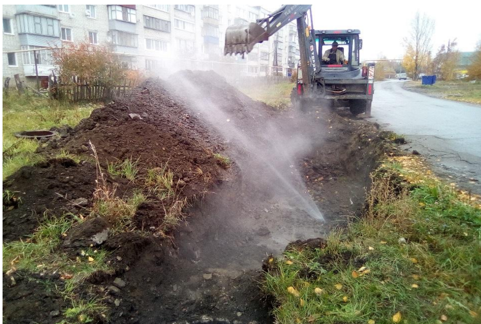
Рис. 5. Аварийные работы по устранению порыва теплотрассы. Р. п. Ишеевка, октябрь 2019 г.
