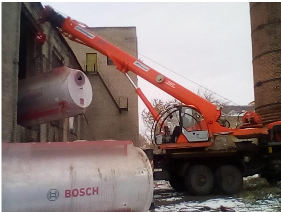
Фото 3 . Р. п. Ишеевка, котельная №2, ул. Ульянова, 1П, ноябрь 2017 г.
