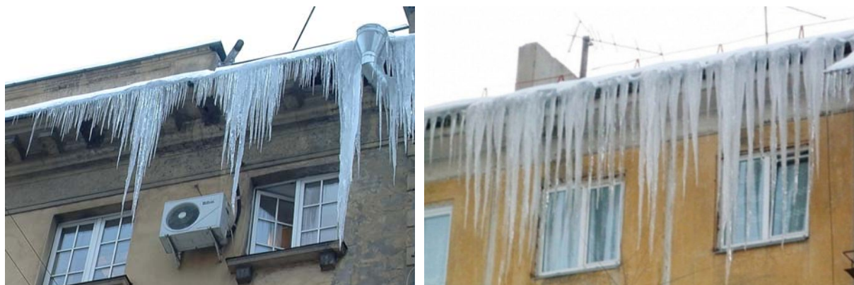
Рисунок 8 – Образование наледей при открытых оконных створках
