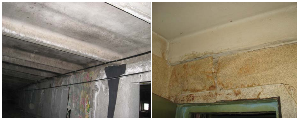
Рисунок 9 – Примеры образования конденсата на конструкциях технического холодного этажа, но с остекленными продухами, выпадения «осадков» и протечек в квартире, расположенной ниже
